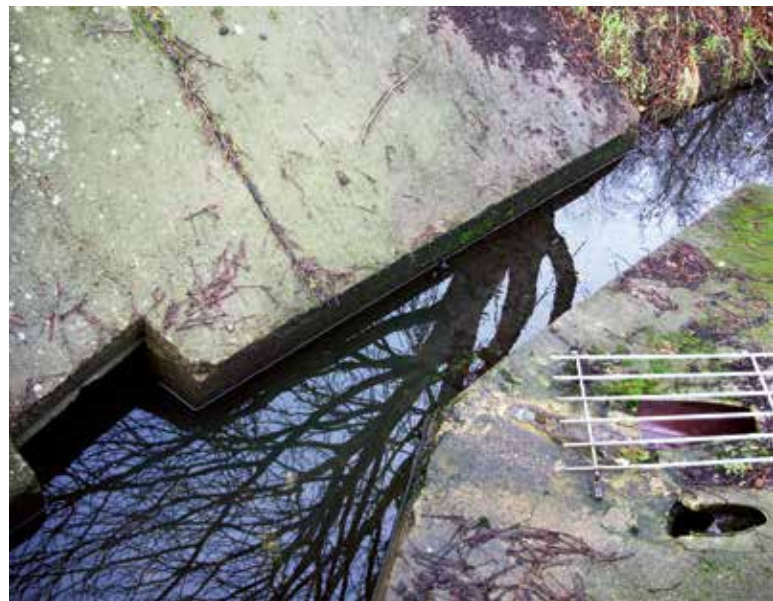
Das Ufer des Zingergrabens ist durch Beton stark verbaut. Dazu kommen noch Einleitungen von der Straße.
