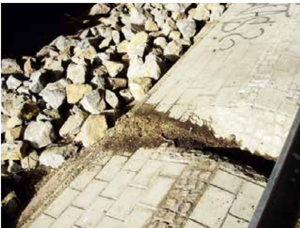
Hier muss gehandelt werden: Eine Einleitstelle für ungereinigtes Straßenabwasser in ein Wasserlauf.
